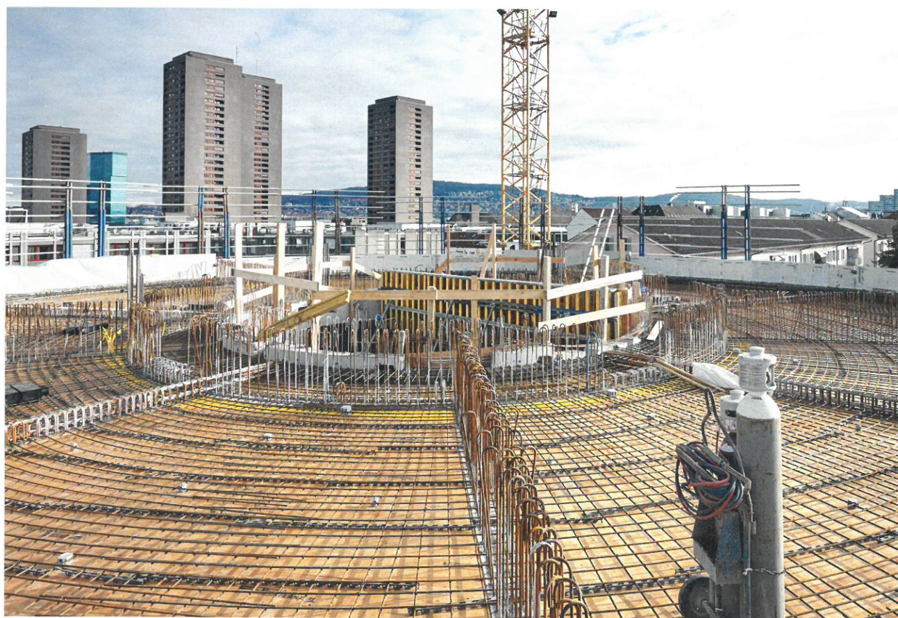
Der Kernbereich mit den Turmschaftwänden überträgt die Lasten des kreisförmigen Wohnzylinders auf die Fundation.
